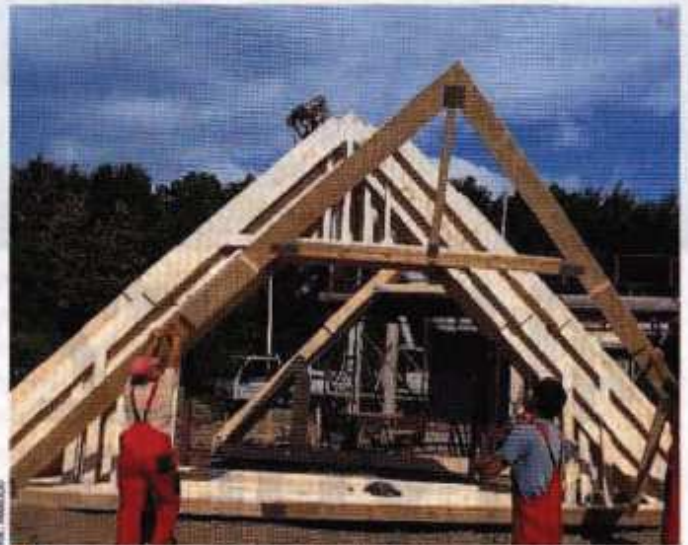
7 Wiązary gotowe są dość lekkie, można je więc przetransportować na górę bez konieczności użycia dźwigu
