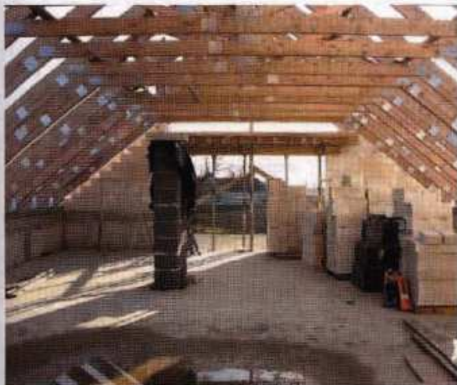
8 Gdy wszystkie wiązary są już ustawione i zamocowane do murłaty lub wieńca, można układać materiał wstępnego krycia i pokrycie dachowe
