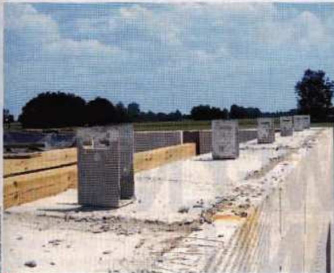
6 Okucia przygotowane do zamocowania wiązarów kratowych w żelbetowym wieńcu dachowym (bez murłaty)
